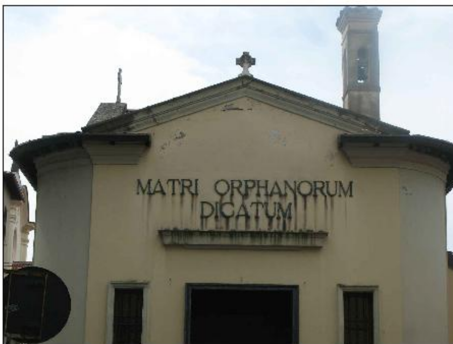
Foto 6: prospetto Nord - dettaglio del degrado di facciata
