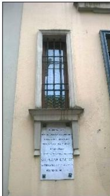
Foto 8: prospetto Nord - dettaglio del degrado di facciata
