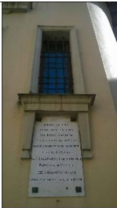
Foto 9: prospetto Nord - dettaglio del degrado di facciata
