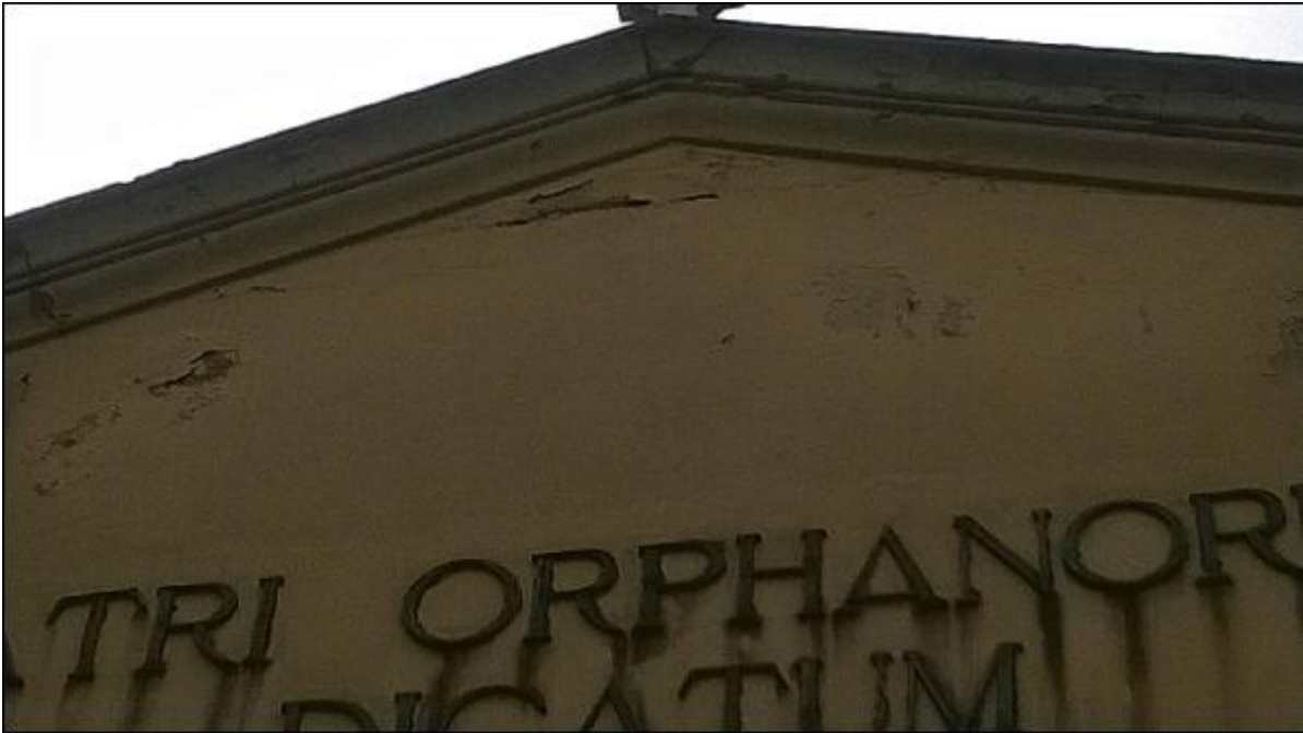
Foto 7: prospetto Nord - dettaglio del degrado di facciata
