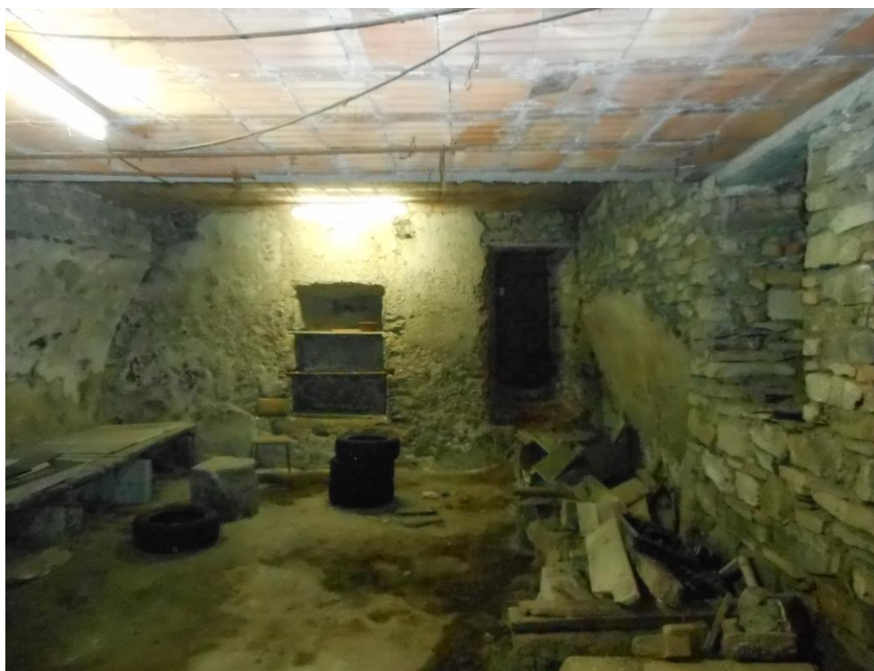
Il solaio di laterizio e intonaci degradati e decoesi
