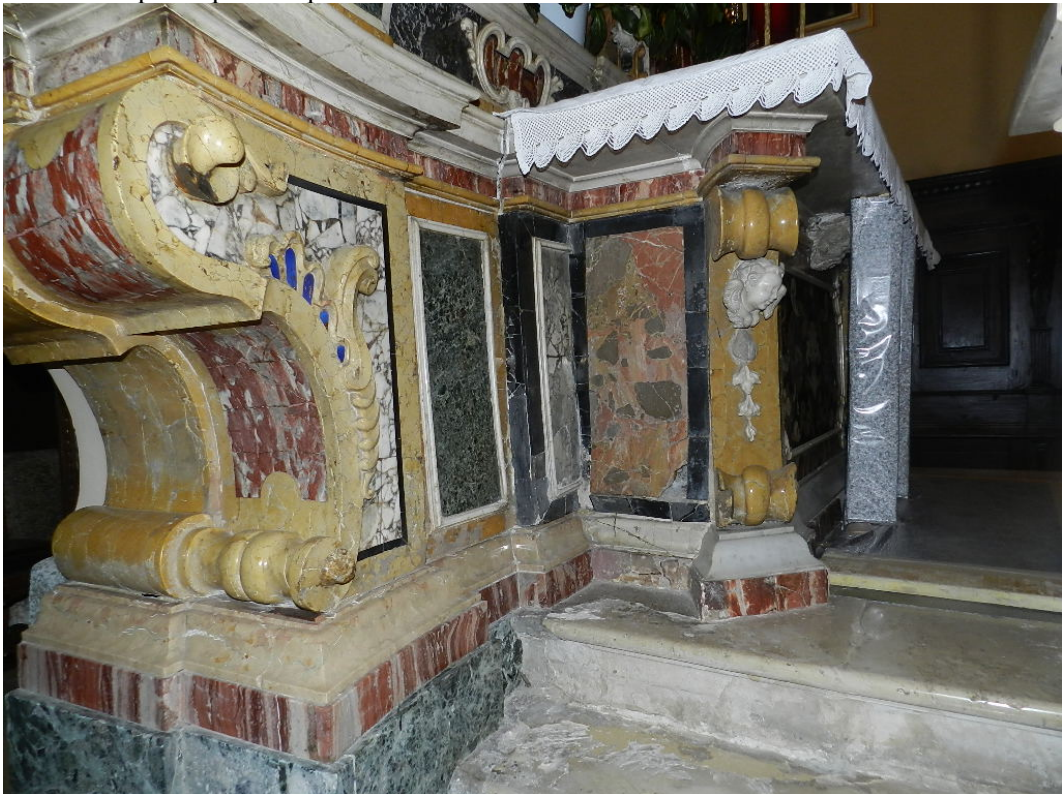
Degrado lato sinistro
