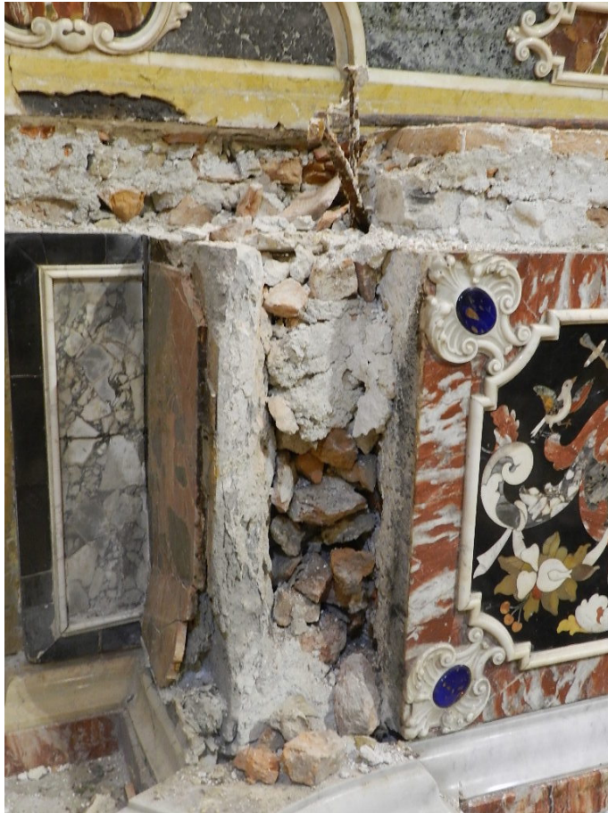
Degrado della pietra arenaria interna con spanciamenti delle parti inferiori
