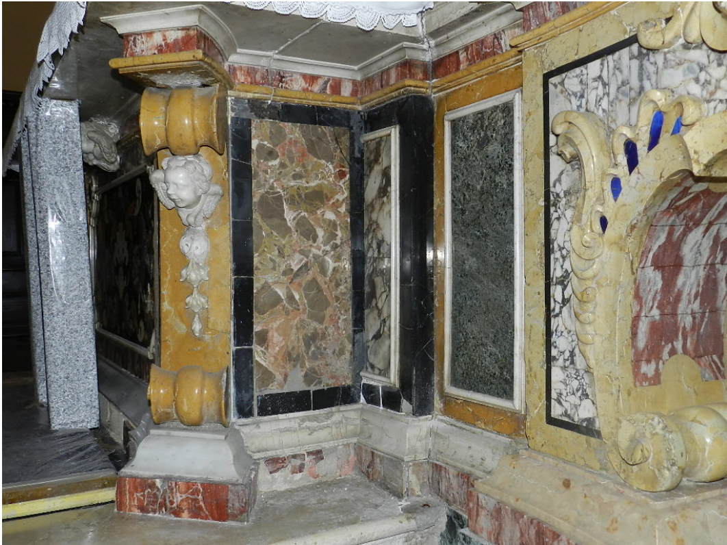
Degrado lato destro
