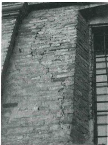
Fig. 7. Sulla facciata di Santa Lucia la traccia degli oculi originari è definita dal bordo di strato tra la muratura seicentesca stilata con la malta rosso-rosata e il tamponamento della spalla della finestra settecentesca.
